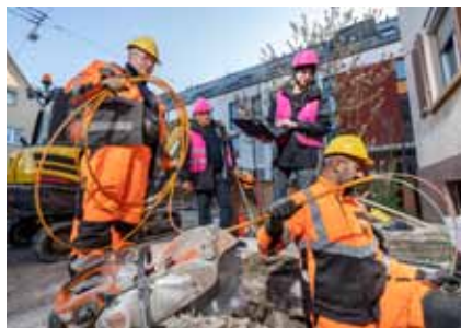
Die Telekom erschließt in Thalheim und Stollberg jedes unserer Gebäude mit Glasfaserleitungen.
